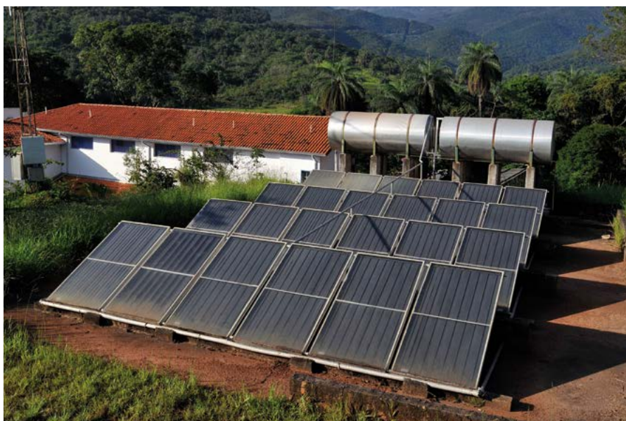
Painéis de aquecimento solar na Fazenda do Engenho Local, em Santa Bárbara (MG), 2014.
